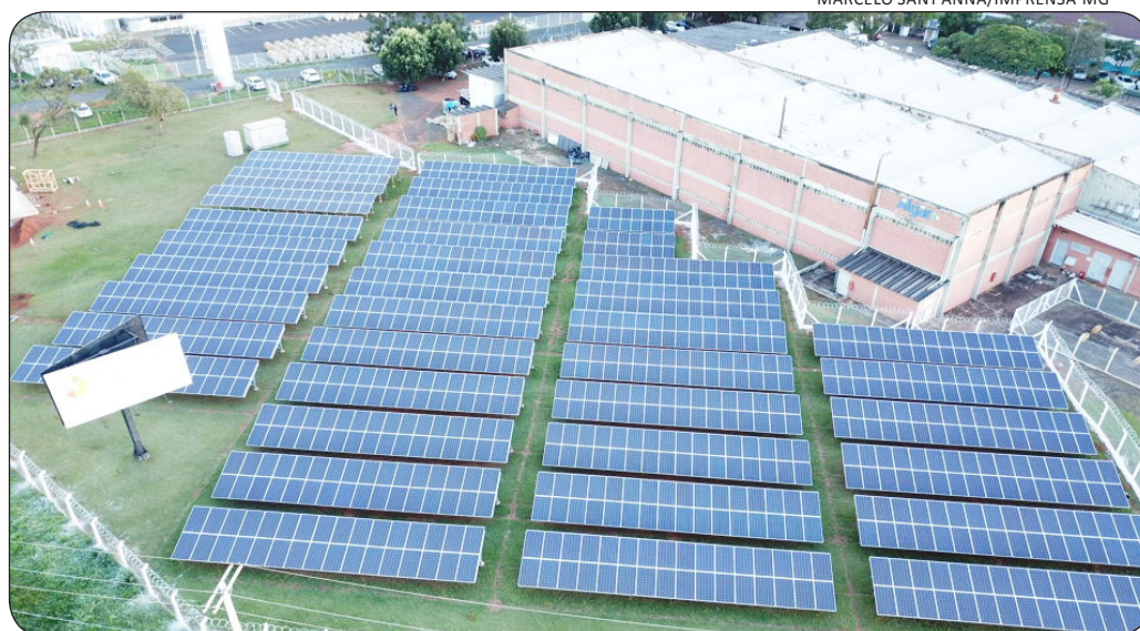
Projeto pioneiro busca a eficiência energética e a melhoria da qualidade de rede, disponibilizando mais energia para o consumidor
